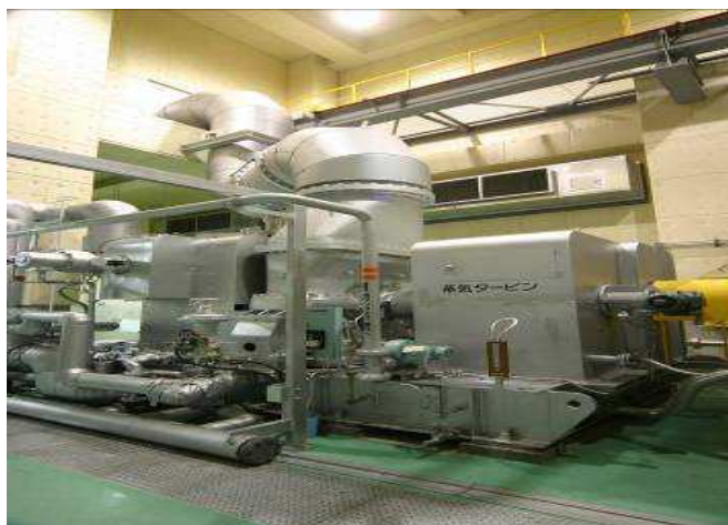
【蒸気タービン & 発電機】
