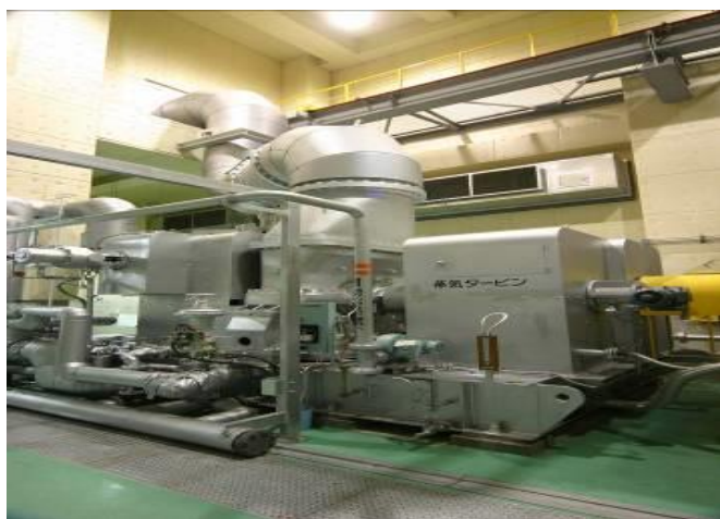
【蒸気タービン&発電機】
