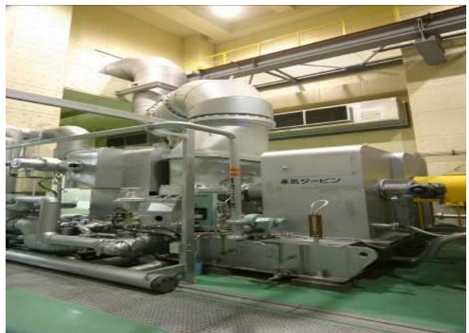
【蒸気タービン&発電機】
