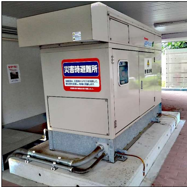
災害時用プロパンガス発電機
