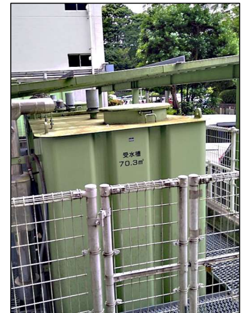
災害に強い鉄製受水槽
