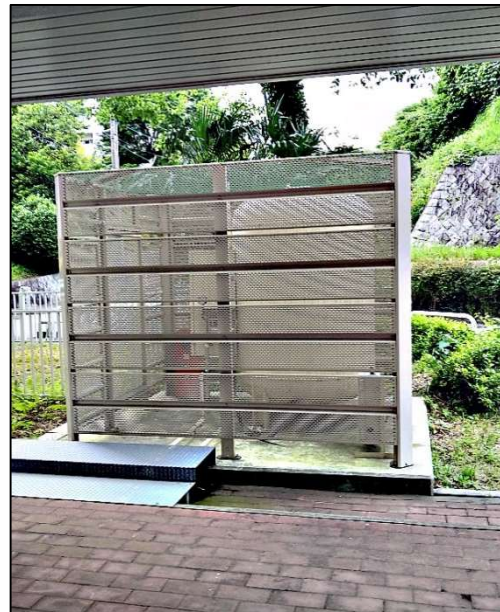
災害時用プロパンガスタンク
