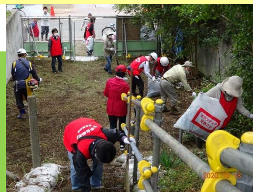
津波避難場所の設置(辻堂地区)
