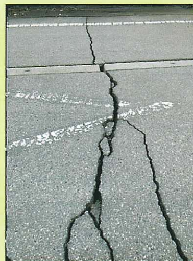
能登半島地震で寸断された道路
