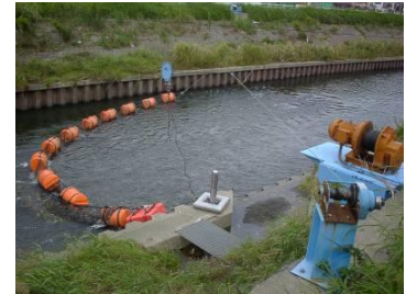
境川除じん機(大清水橋上流)
