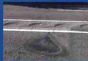
穴ぼこを補修し、安全を確保！
